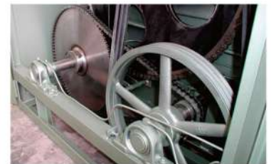
機械室内部グリス配管
