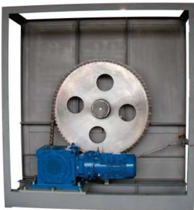
ギヤードモーター仕様機械室
